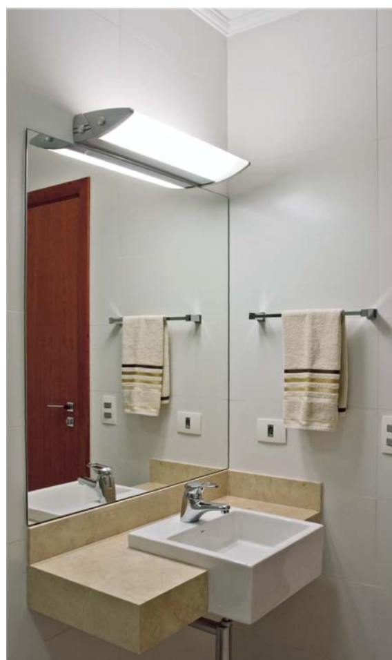
Sobre o espelho, acima da cuba do banheiro, há uma luminária de sobrepor tipo arandela com duas fluorescentes tubulares T5, de 14W, com difusor em PMMA frisado.
